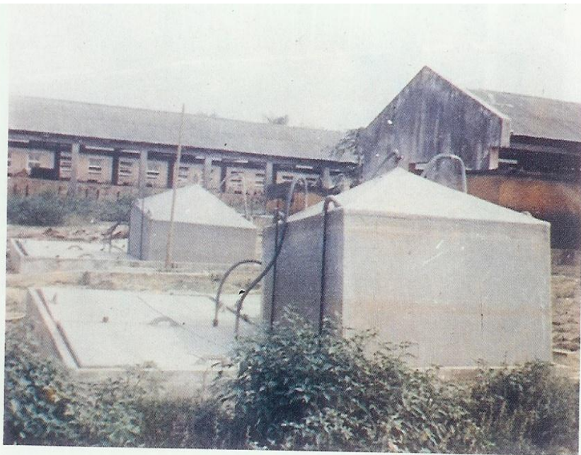
圖 5-3-10 複式厭氣醱酵槽——上覆玻璃纖維覆蓋
